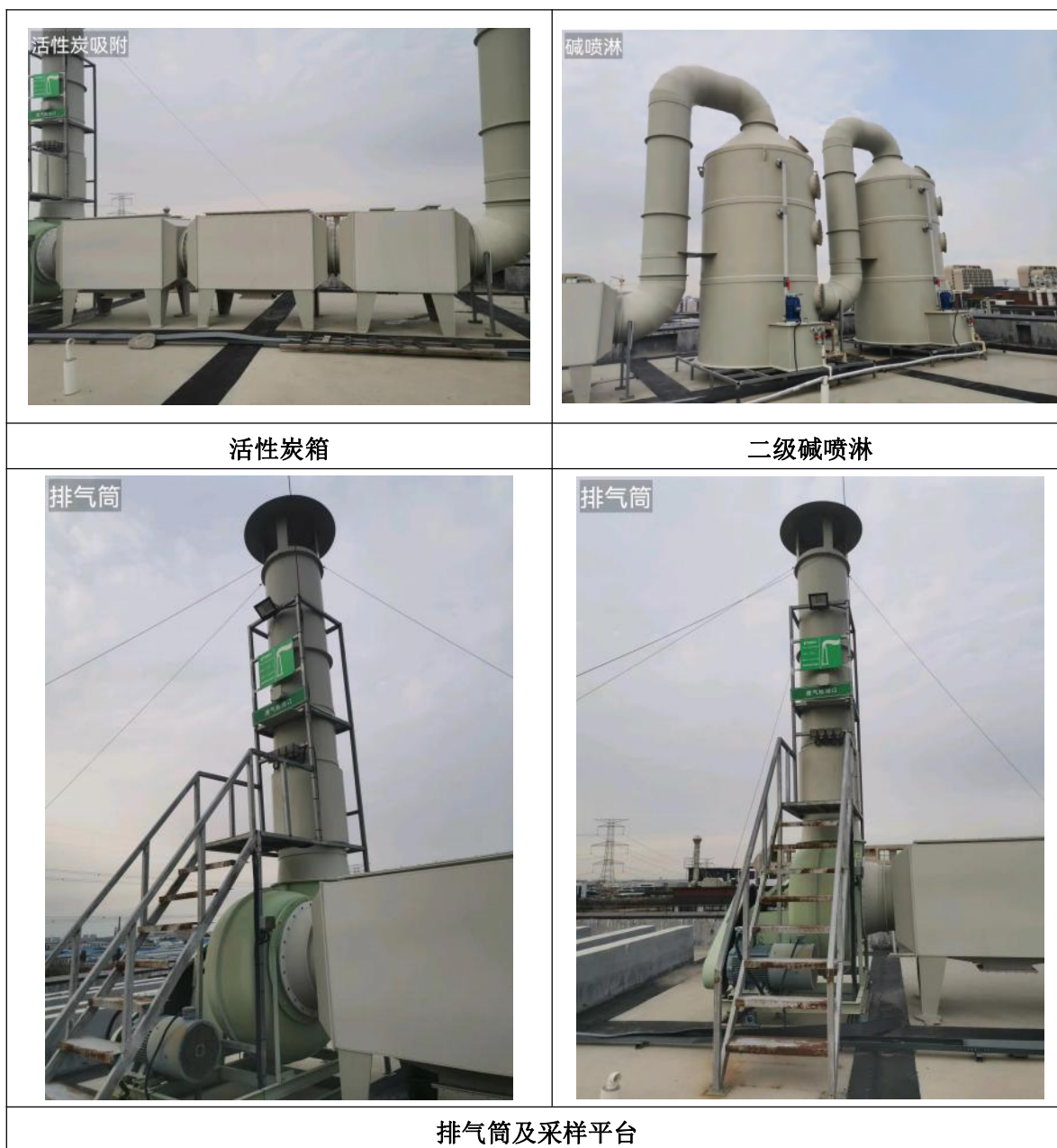
图 4.1-3 本项目废气治理设施图
