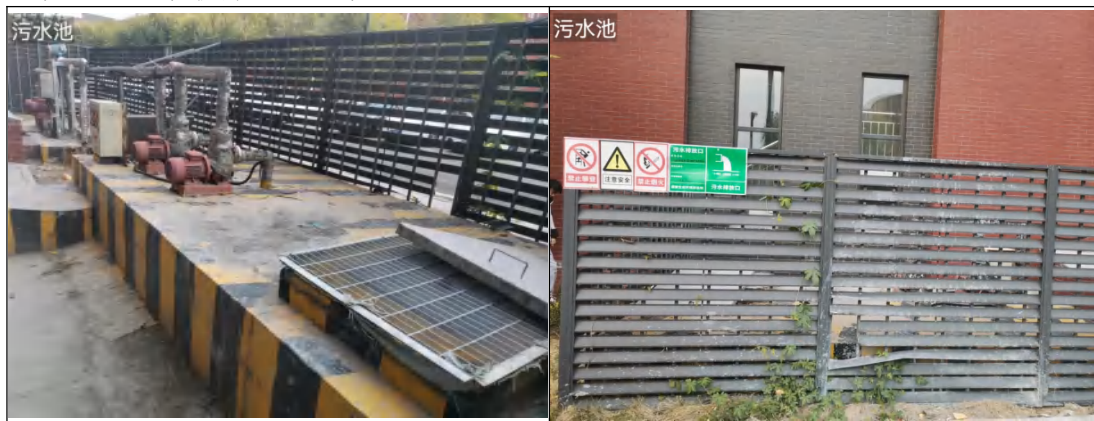
图 4.1-2 本项目污水收集池及排放标识
